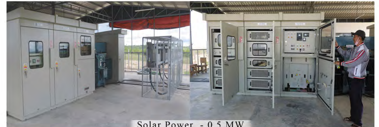
Solar Power - 0.5 MW
